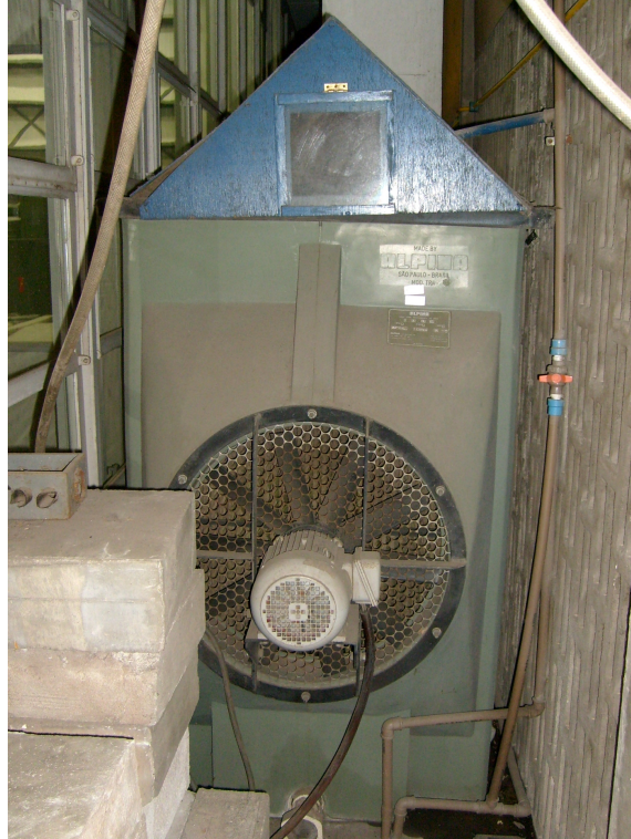
Figura 10 - Torre de resfriamento de água Fonte: Arquivo pessoal.
